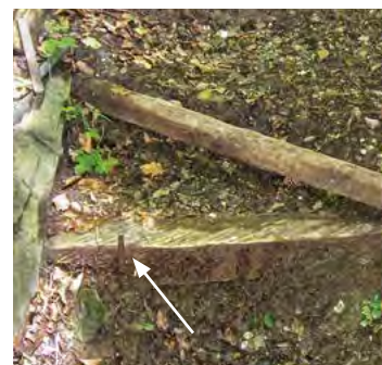
Fig. 110 Elementi di fissaggio sporgenti
