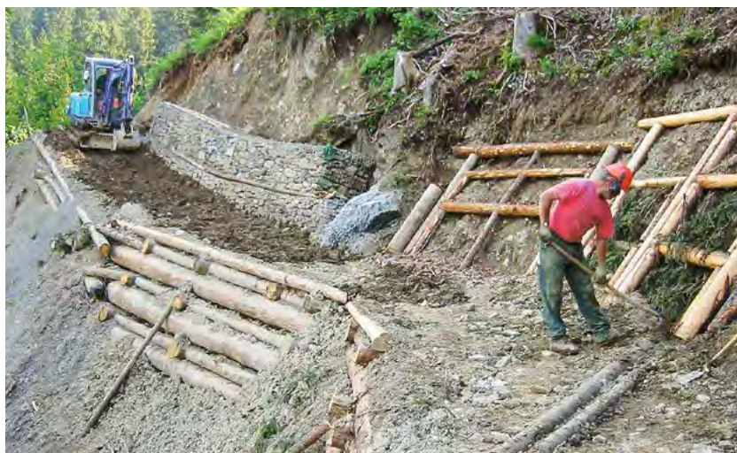
Fig. 104 Consolidamento di una scarpata con palificate di sostegno (a sinistra), gabbioni (sullo sfondo) e grata di sostegno (a destra)
