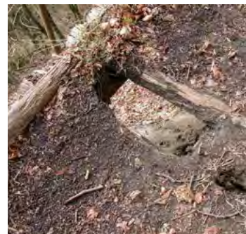
Fig. 114 Cedimento del margine del sentiero
