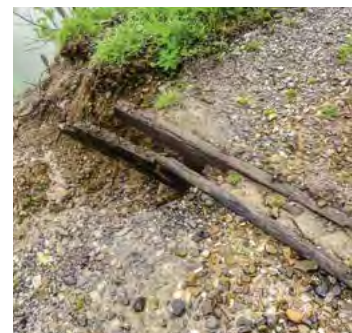
Fig. 118 Scarsa manutenzione di una canaletta trasversale
