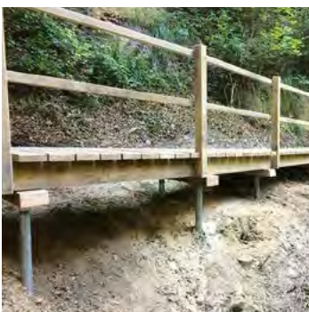
Fig. 68 Le fondazioni con viti di ancoraggio sono un'alternativa alla realizzazione di spalle massicce.
